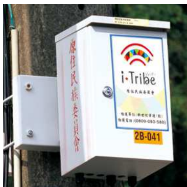
室外箱設備標示
