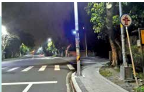
易肇事或昏暗危險易自撞（摔）路段，安裝藍紅 LED 爆閃燈，維護行車安全。
