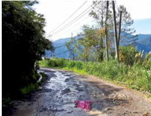
路面坑洞改善前
