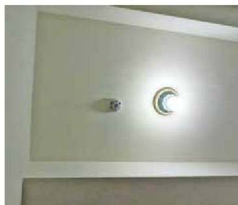
住宅用火災警報器安裝於天花板樣貌（燈泡左側圓形物）
