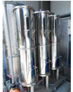
脫硫設備改善沼氣純度
