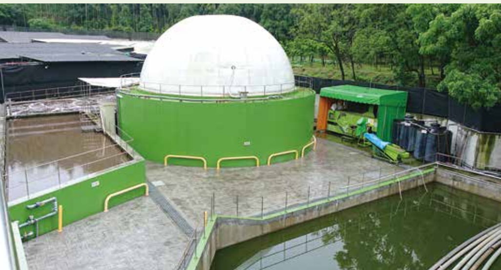
新合興牧場為沼氣並聯發電建置新型二段高效厭氧發酵槽，白色球狀體內呈現飽滿的沼氣收集狀態，發酵槽體由瑞助營造股份有限公司負責設計施工。
