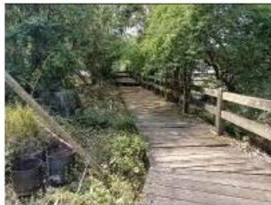
木頭腐舊、步道破損
