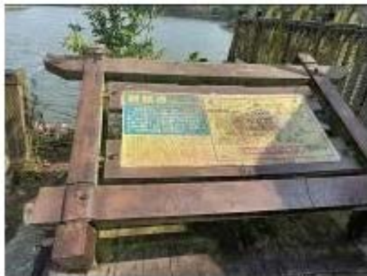
既有導覽設施破損
