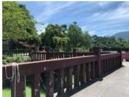
景觀橋欄杆高度不足
