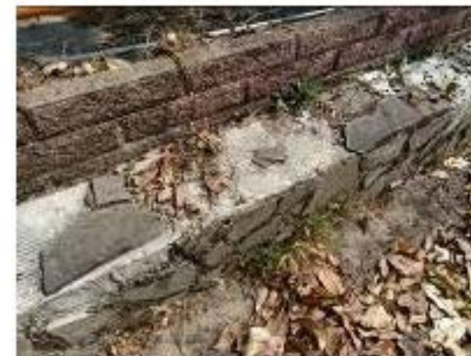
構造物破損嚴重
