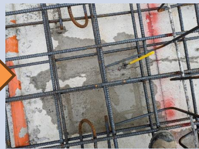
6. 施工過程造成破管
