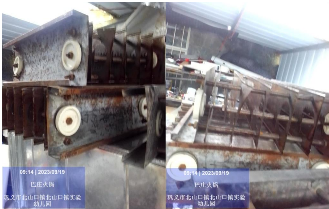
A.防制設備清洗前照片
