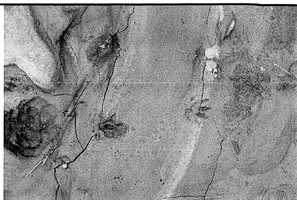
鼠類腳印(施工前)
