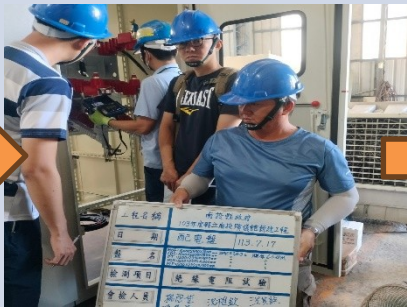
2. 絕緣電阻測試
