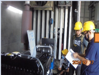
1. 發電機規格確認
